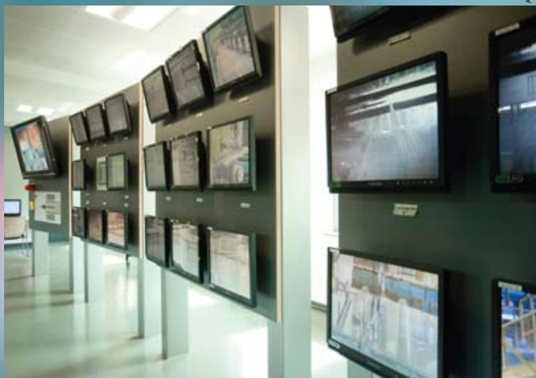
A true gem: the control room
